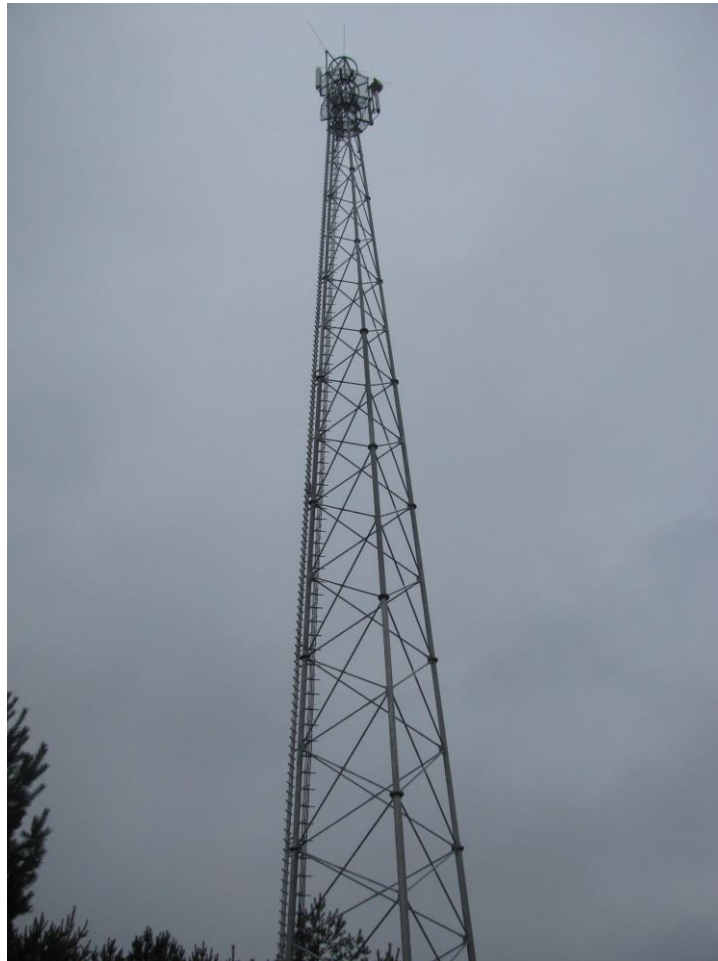
Zał. nr 1: Widok ogólny instalacji radiokomunikacyjnej.
