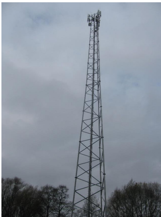
Zał. nr 1: Widok ogólny instalacji radiokomunikacyjnej.
