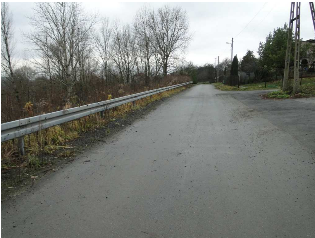
Fot. 5. Stan nawierzchni ulicy Szerokiej powyżej skarpy głównej osuwiska JK8 (ID 18975) w Wysokiej w grudniu 2015 r. Widok w kierunku zachodnim.
